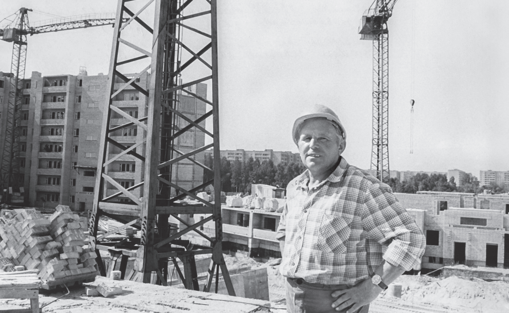
Строительство трех 9-этажных домов в квартале 23 (ул. Понтекорво, д. 18, 20, 22 — «семерки»). Бригадир подрядной бригады А. А. Цветков. 1985 г.
